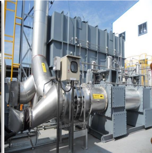
蓄熱式焚化爐DeVOC設備
