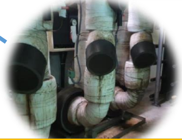
校正區域泵壓力表及變頻器
