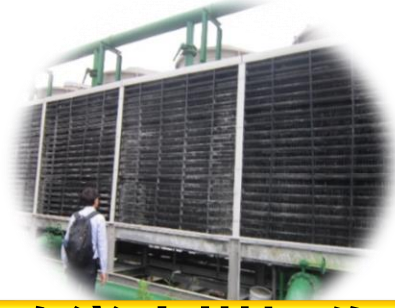
改變水塔操作方式
