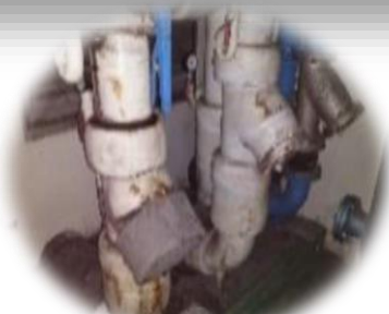
汰換低效率冰水主機
